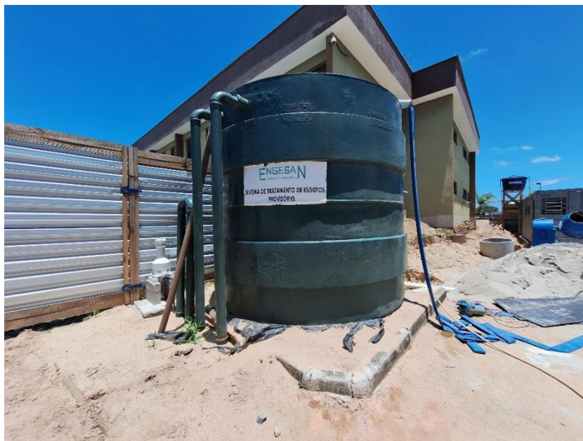
Sistema de Tratamento de Esgoto Provisório.
