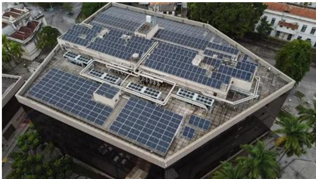
Placas fotovoltaicas instaladas.
