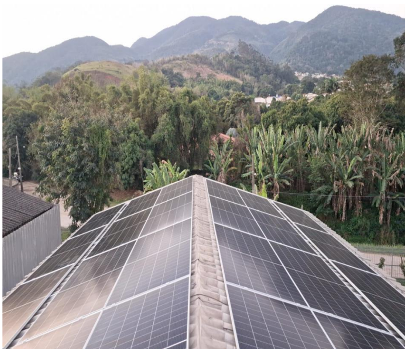
Placas fotovoltaicas instaladas.
