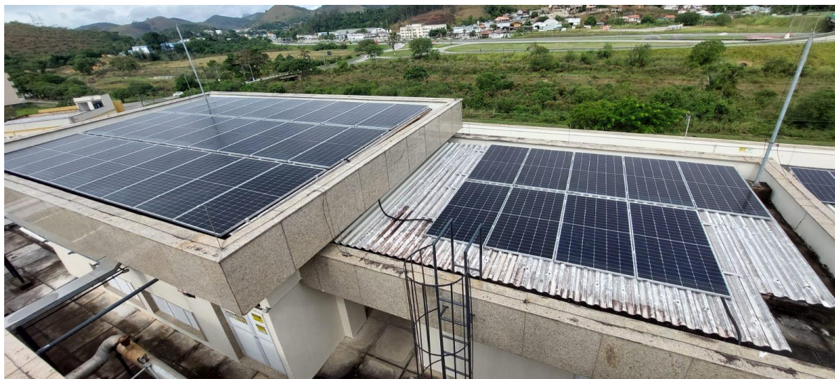
Placas fotovoltaicas instaladas.
