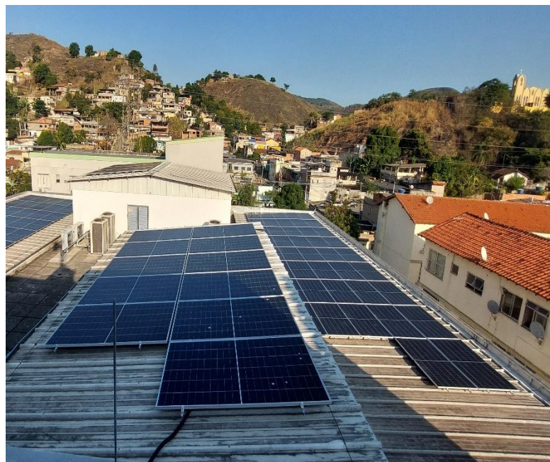
Placas fotovoltaicas instaladas.
