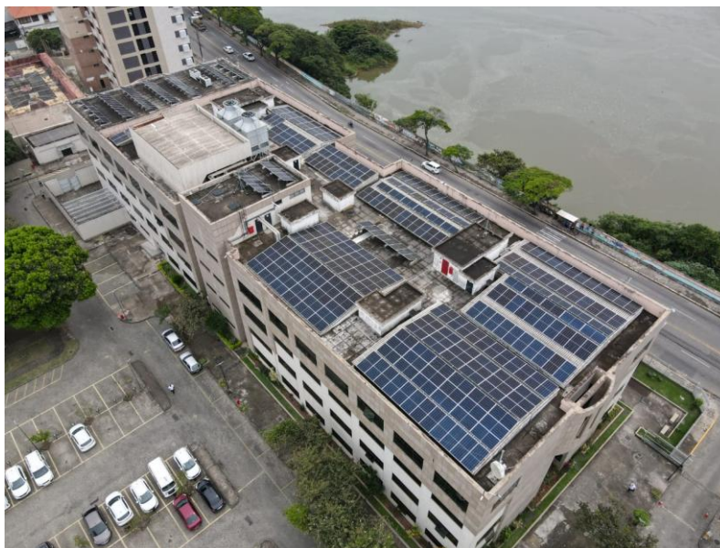
Placas fotovoltaicas instaladas.
