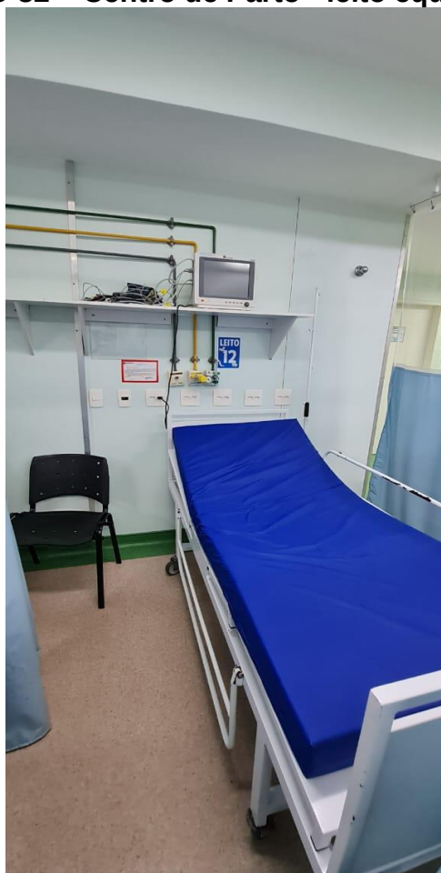
FOTO 32 – Centro de Parto - leito equipado
