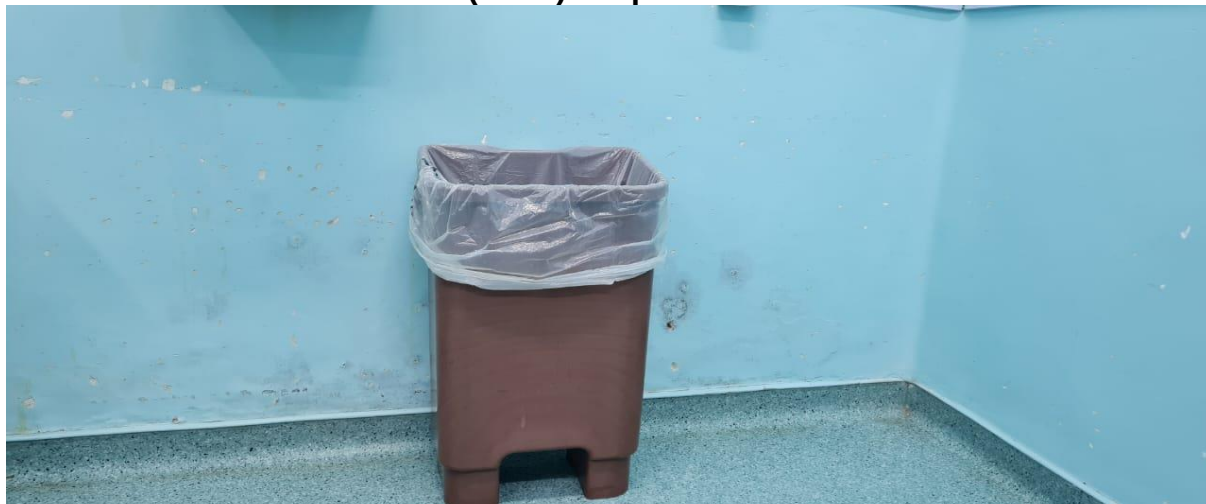
FOTO 41 – Centro obstétrico - sala cirúrgica - evidência de colonização fúngica (mofo) em paredes
