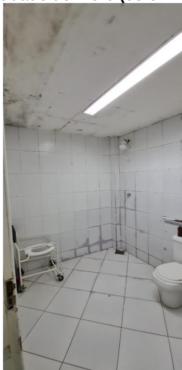
FOTO 44 – Banheiro do Centro Obstétrico - péssimas condições de conservação – grande quantidade de mofo (colonização fúngica)
