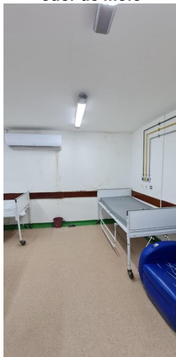
FOTO 19 – Enfermaria com problemas em equipamento de ar condicionado e forte odor de mofo
