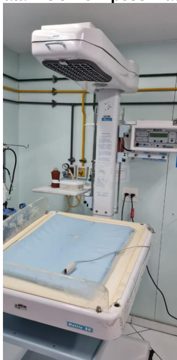
FOTO 49 – UI neonatal - UCR em péssimas condições de uso
