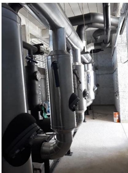
Casa de bombas de ar condicionado
