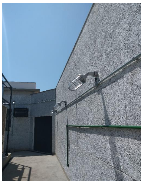
Área externa dos chillers com tratamento acústico
