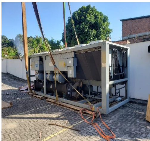
Chiller antigo acondicionado temporariamente no pátio do Fórum
