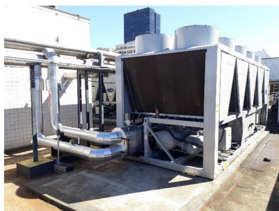
Chillers novos instalados e em funcionamento
