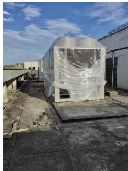
Chillers novos posicionados na cobertura
