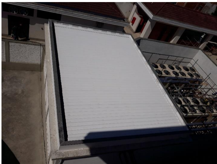
Vista superior dos novos chillers
