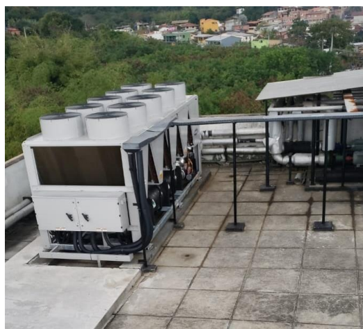
Chiller novo instalado e em funcionamento
