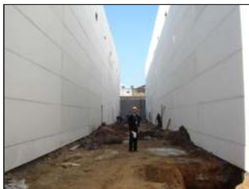
Visão das laterais dos Centros de Informação, onde serão instalados os exaustores.
